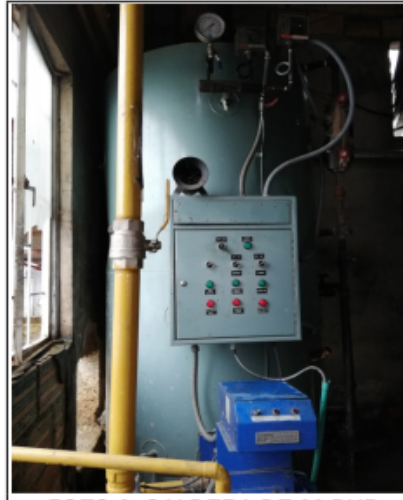
FOTO 2. CALDERA DE 30 BHP
