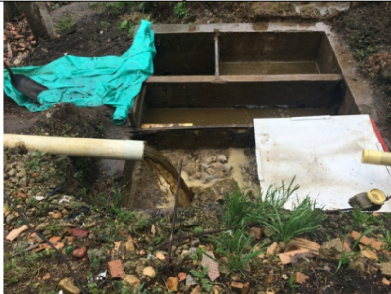
Fotografía 15. Descarga de ARND (agua sangre y materia orgánica), la cual se conecta con la tubería de agua lluvia y es descargada al suelo
