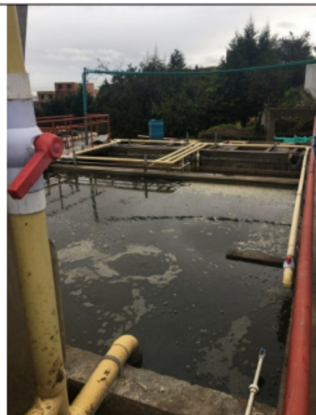
Fotografía 2. Laguna facultativa y aireada
