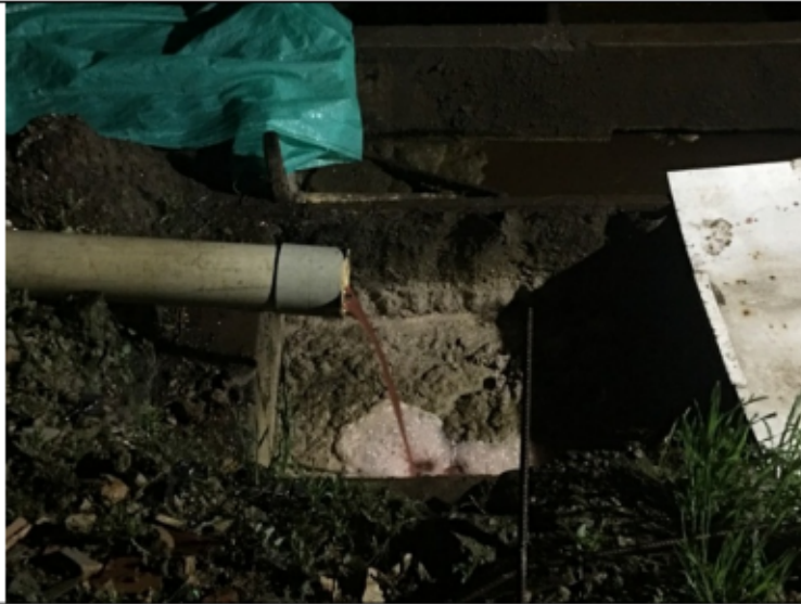
Fotografía 14. Descarga de ARND (agua sangre), la cual se conecta con la tubería de agua lluvia y es descargada al suelo
