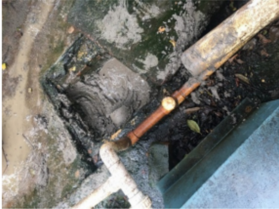
Fotografía 16. Taponamientos de la descarga 1 y 2 (salida de la PTAR)
