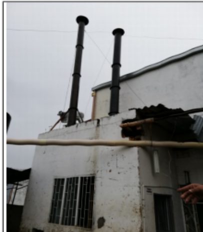
FOTO 1. DUCTOS DE LAS CALDERAS
