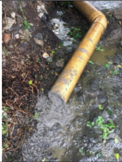
Fotografía 17. Taponamiento de la descarga 3 (ARnD, mezclada con agua lluvia)
